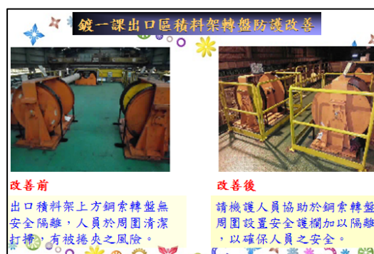
撲滅環境/設備不安全點改善案例
