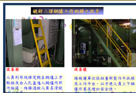
撲滅環境/設備不安全點改善案例
