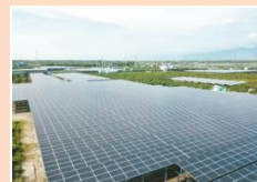
屏東佳冬瑤光案(地面型) 光支彩烤漆鋼板
