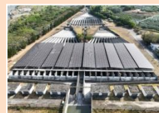
南投集集攔沙壩(地面型) 光支彩烤漆鋼板
